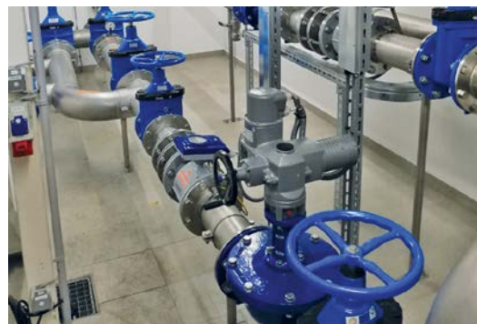
Tubazioni per il raffreddamento degli impianti di produzione
