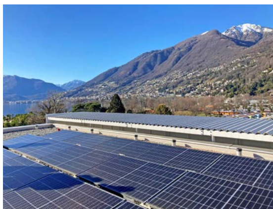
Neue PVA auf dem Areal des Centro Sportivo Tenero (CST) (Foto: Sabine Bachmann)
