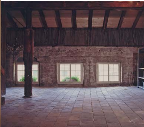
Estrich Nord mit Winde
