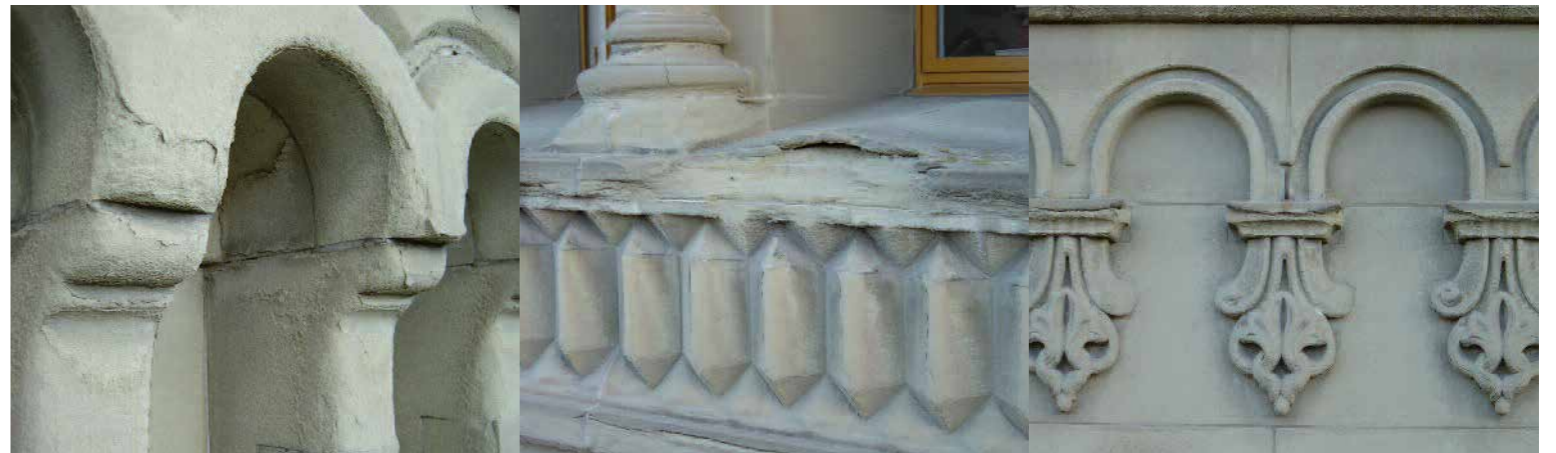
Facciata del corpo mediano verso nord: arenaria guasta e alterata dalle intemperie, prima del risanamento
