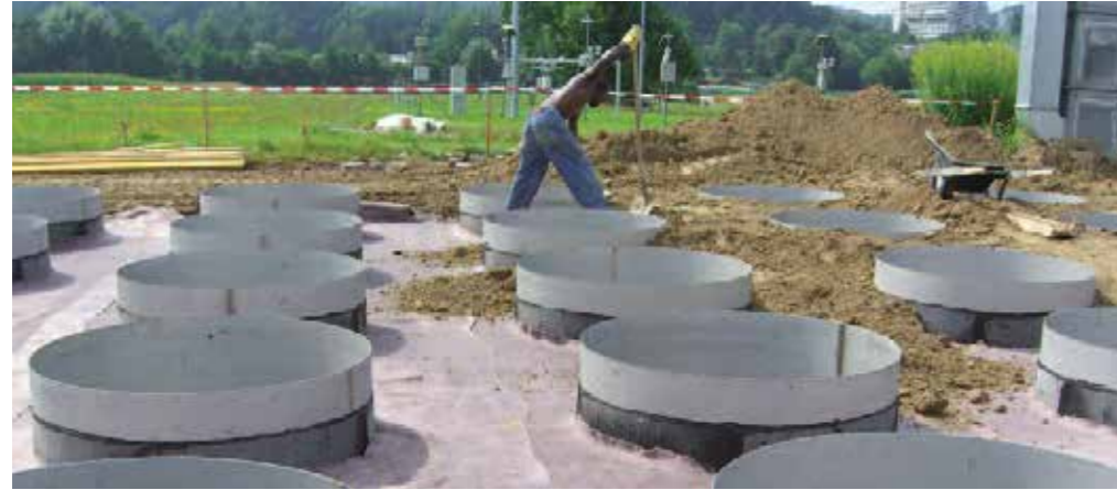
Impermeabilizzazione con strato protettivo sul soffitto Posa della copertura in terra (materiale di sterco e humus) sul calcestruzzo del soffitto
