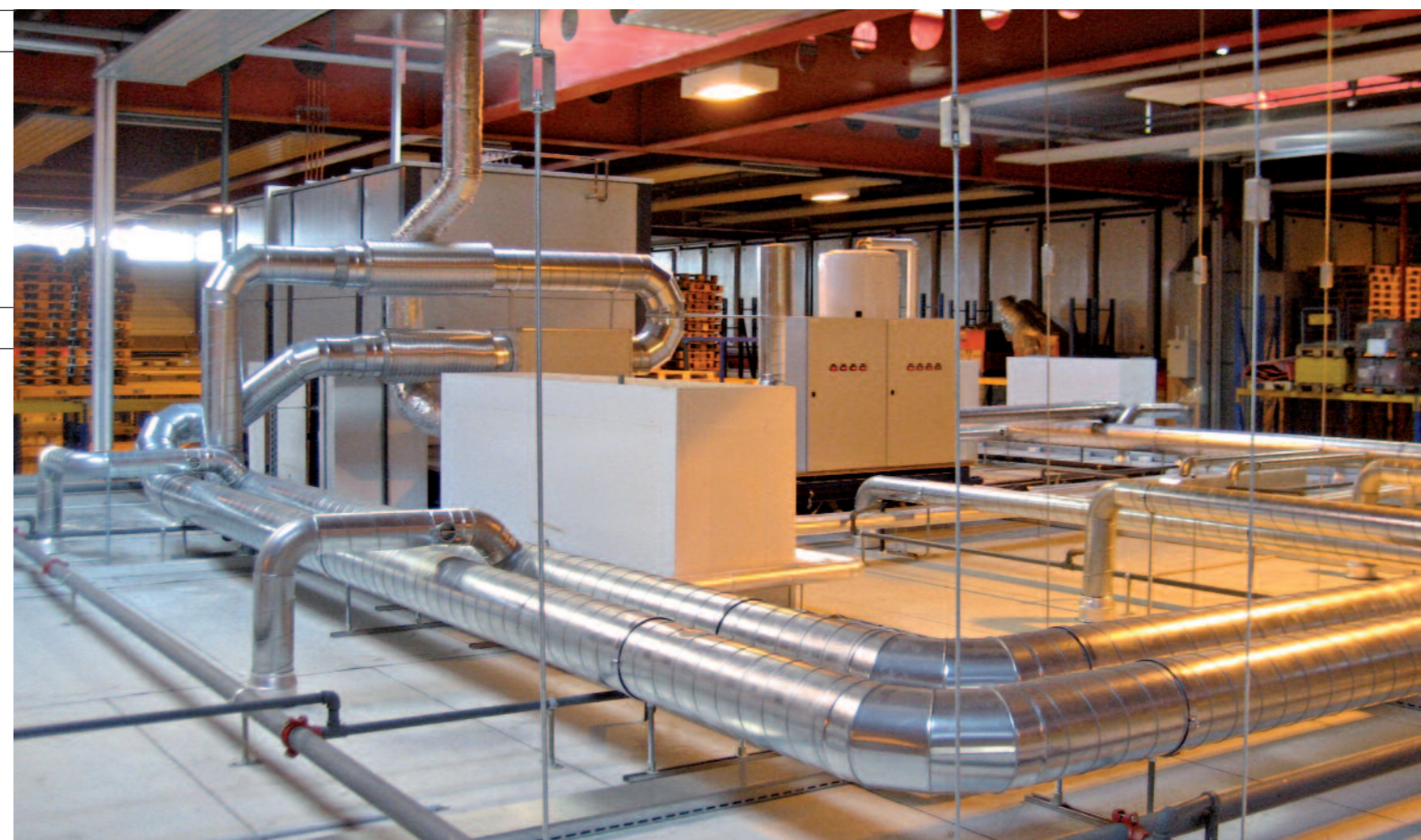
Centrale de réfrigération
