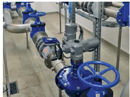
Réseau de tuyauterie pour le refroidissement de la production
