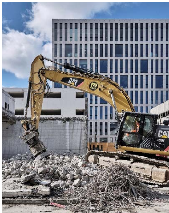
Beim Rückbau von Einstellhalle und Tankstelle werden die Materialien sorgfältig getrennt. (Foto: Rolf Siegenthaler)
