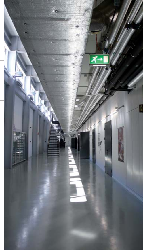
Haustechnische Installationen Korridor EG/Trakt B
