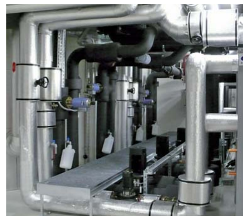
Verrohrung der Wärmepumpen (isoliert)
