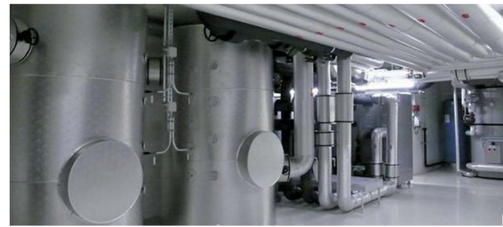
Heizungsspeicher in der Zentrale
