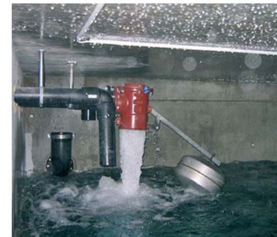
Mischbecken mit Schwimmerventil
