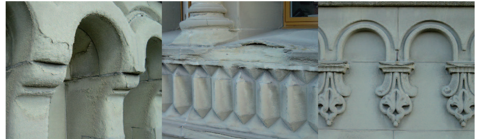
defekter und verwitterter Sandstein vor der Sanierung, Fassade Mittelbau Nord
