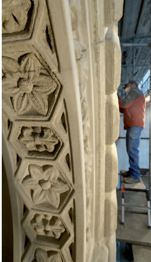
Verzierungen Rundbögen Haupteingang, oben vor und unten nach der Konservierung
