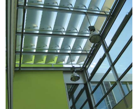
* Fotovoltaikanlage über Lichthöfen
