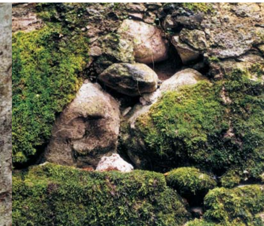
Ausgebrochene Stelle in der Ringmauer (Nordseite)
