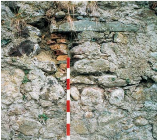
Abplatzung vor der Restaurierung
