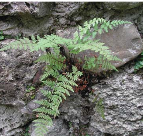
Blasenfarn und Lebermoose an der Maueroberfläche
