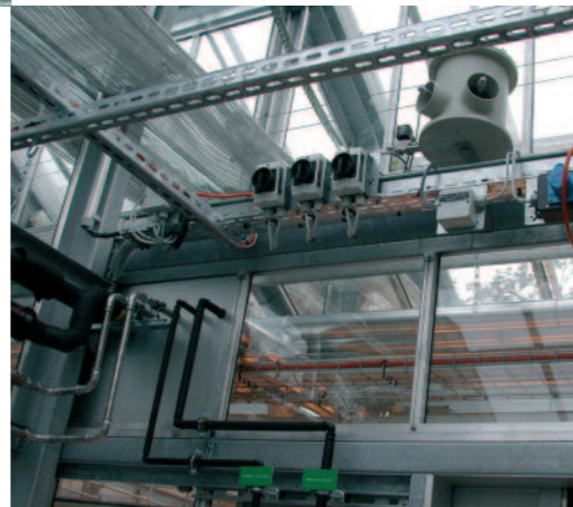
HT-Anschlüsse der Kabinen
